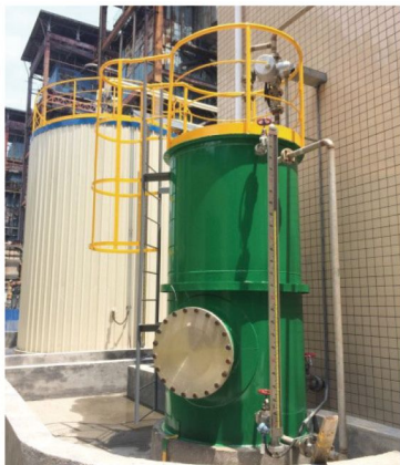
尿素溶解罐储罐
